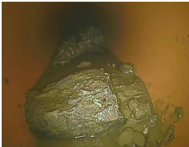
2. ábra d 200-as KGPVC csatorna részleges keresztmetszeti csökkenése
