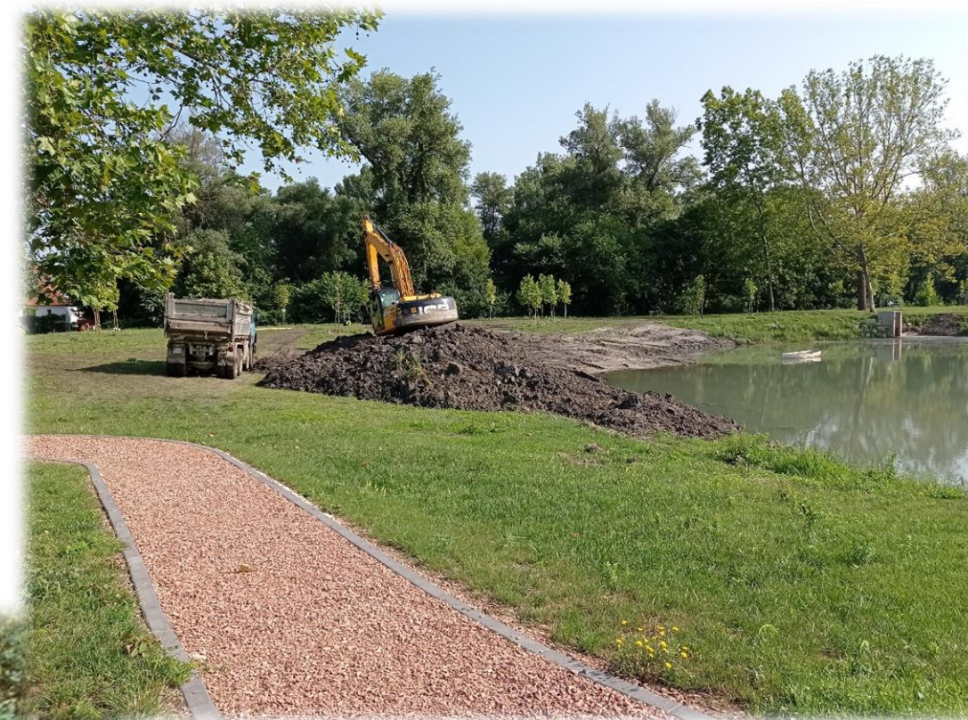
Teljes mederkotrás, kotrási anyag hulladéklerakóba szállítása, vagy több méter mélyre történő elásása.
